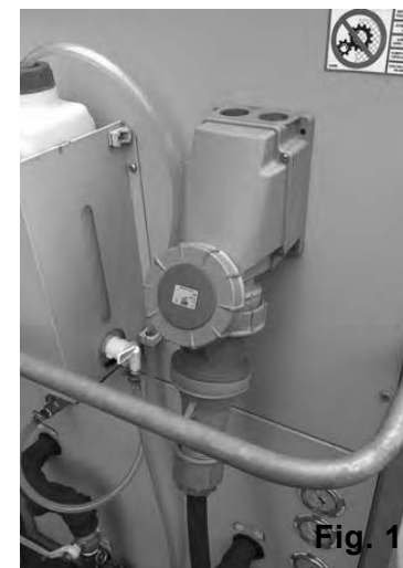
Fig. 1 - Connecteur d'entrée 400 volts, 125 ampères, 5 pôles, qui se trouve sur le groupe froid de 100 kW
